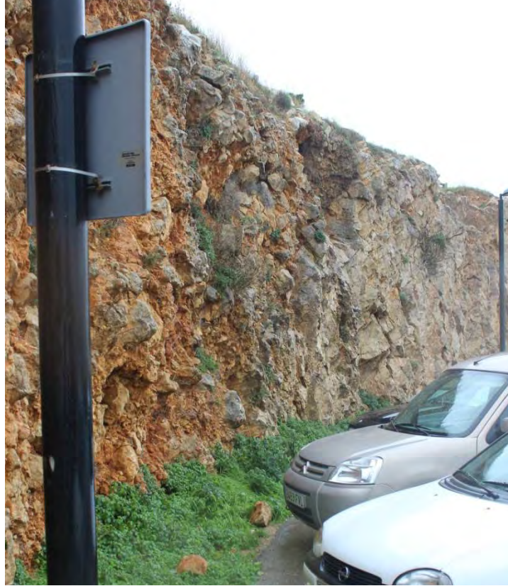
Fotografia 15. Detall del talús de l'aparcament del Pedró de la Creu on s'hi identifiquen dos blocs decimètrics caiguts al peu del talús, segurament desplaçats de la seva situació original per no interferir a l'aparcament.
