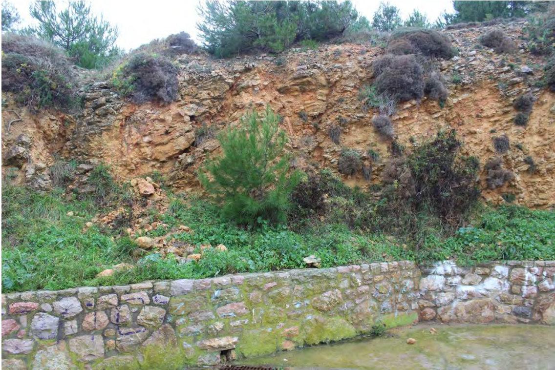
Fotografia 17. Detall de la zona d'aparcament més proper al sector de les Planasses, on s'observa l'estructura tabular a les calcàries que afavoreix el desprendiment
