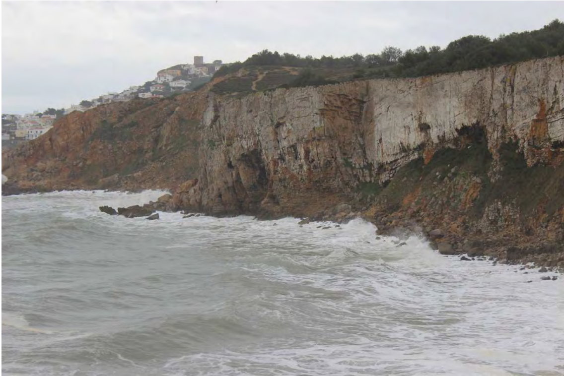
Fotografia 10. Detall de la Punta dels Cinc Sous on s'aprecia l'erosió basal de l'escarpament i l'acumulació de materials caiguts al seu peu.
