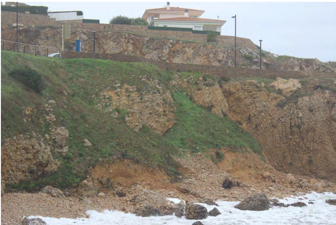
Fotografia 5. Zones d'acumulació de materials provinents de caigudes de blocs i esllavissades de l'escarpament al sector de la Punta del Pedró de la Creu
